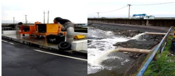
養殖區移動式抽水機汛期抽排減輕災損
